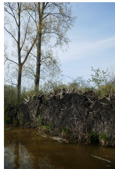
Effondrement d'une berge boisée en peuplier / chablis – Cuvette de Clairmarais commune de Noordpeene
